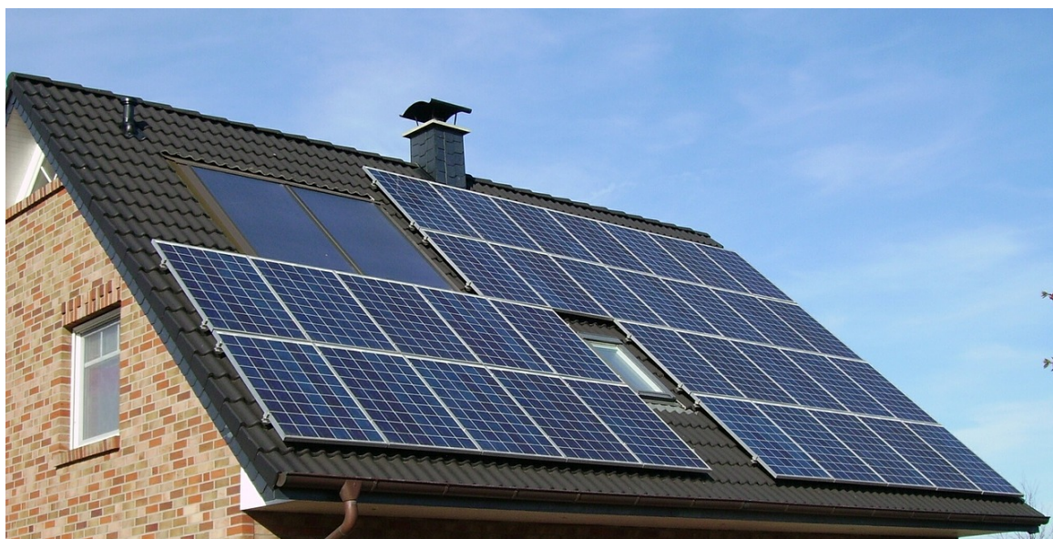
Obrázek 3.4: Fotovoltaické panely na střeše rezidenčního domu jsou dalším příkladem distribuovaného zdroje energie
